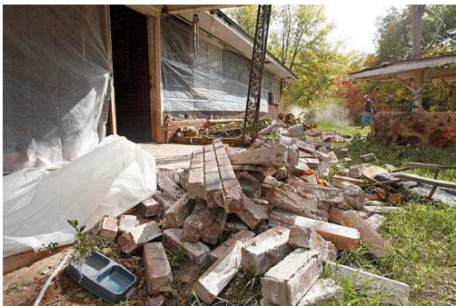
Schäden durch das Erdbeben am 6. November in Oklahoma.
